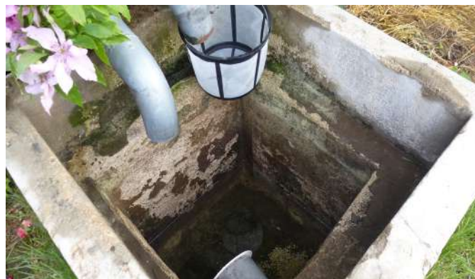
Panier dégrilleur avant entrée dans la citerne
