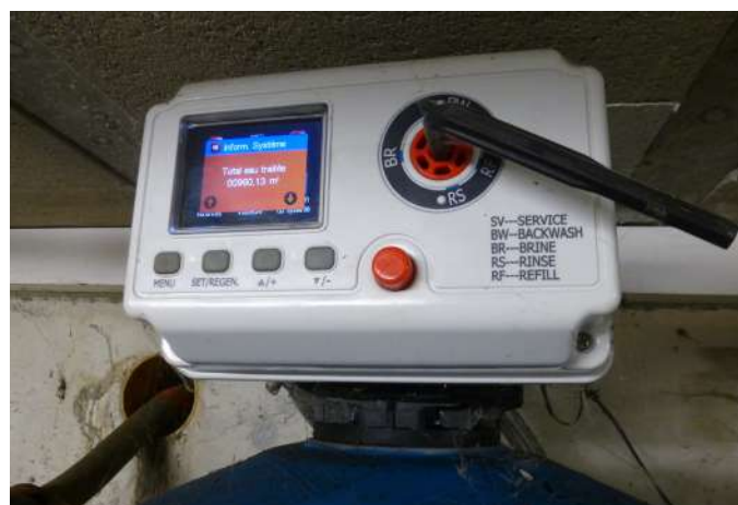
Exemple de compteur comptabilisant les eaux traitées
